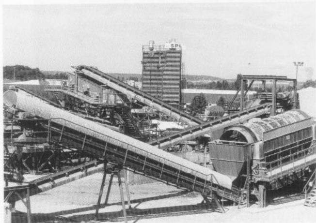
Installation de maturation et d'élaboration des mâchefers
