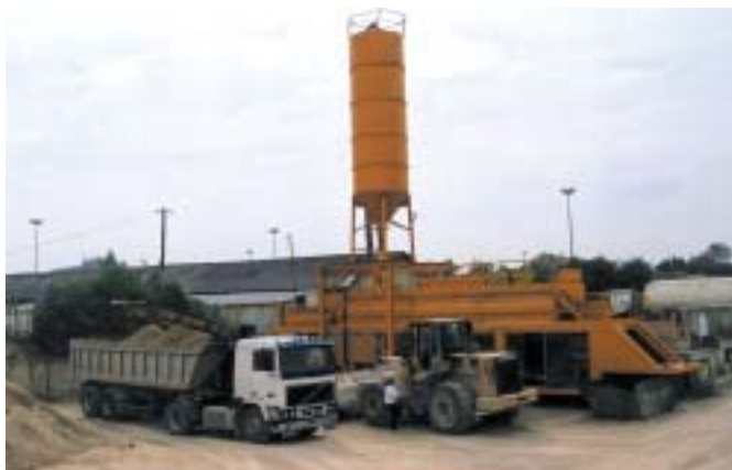
Installation fixe de Gravi France à Bondy (93)
