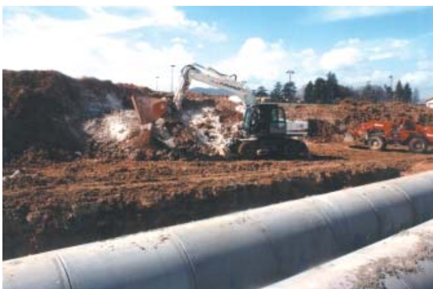
Chantier mobile en région lyonnaise utilisant un godet cribleur et un silo à vis de dosage télécommandée
