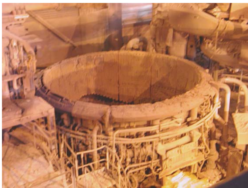
Four électrique ouvert avant chargement
