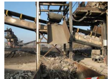
Déferrailage par Overband. (Un ou plusieurs au long de la production, adapté à la granulométrie après les concasseurs).
